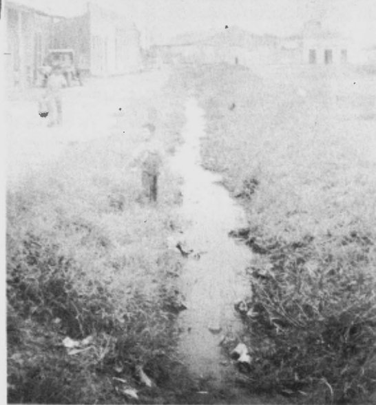
¿Alcantarillado? ¡Nada de eso! En su lugar Bayamo tiene esta "zanja maestra".
