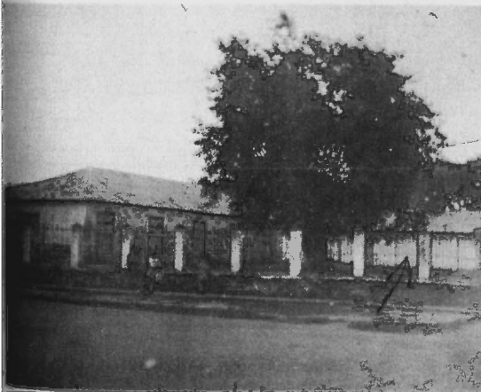
Centro Escolar "José Antonio Saco", sitio de abandono y mal estado sanitario.
